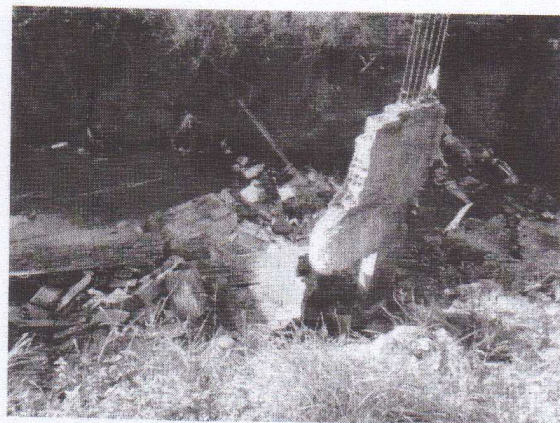
FOTO 06- DETALHE PARA OS EFEITOS DA EROSÃO CONSTRUÇÃO MUITO PRÓXIMA DA GALERIA DE DRENAGEM
