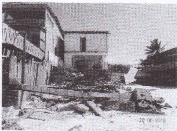
FOTO 21- VISTA GERAL DAS EDIFICAÇÕES DE MADEIRA LOCALIZADAS EM ÁREA DE DUNAS-DETALHE PARA AS RUÍNAS DE CONSTRUÇÕES AFETADAS PELA EROSÃO
