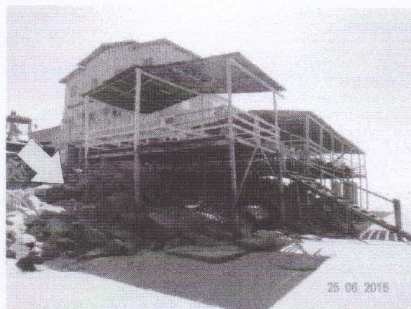
FOTO 26- EDIFICAÇÕES EM CONCRETO ARMADO LOCALIZADAS EM ÁREA DE DUNAS- DETALHE PARA AS CONTENÇÕES DE ROCHAS COLOCADAS POR EMPRESÁRIO NA FRENTE DO EMPREENDIMENTO
