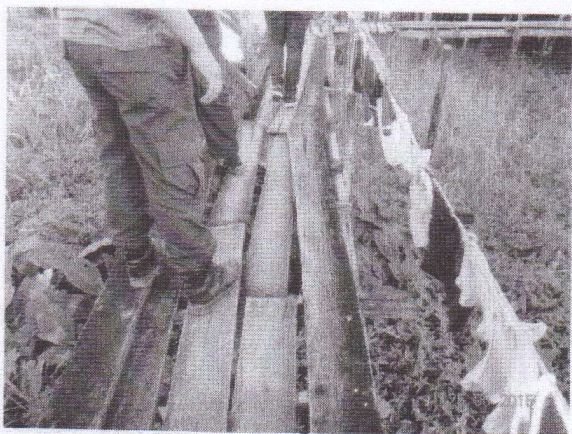
FOTO 07- DETALHE PARA A PONTE (ESTADO PRECÁRIO) RISCO DE ACIDENTES
