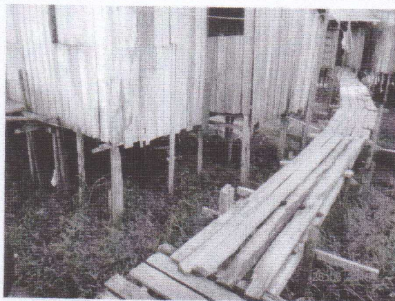
FOTO 08- DETALHE PARA A PONTE (ESTADO PRECÁRIO) RISCO DE ACIDENTES E PARA AS CONSTRUÇÕES DE MADEIRA
