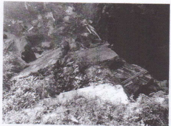
FOTO 10- DETALHE PARA A GALERIA DE DRENAGEM DESTRUÍDA PELA FORÇA DA ÁGUA
