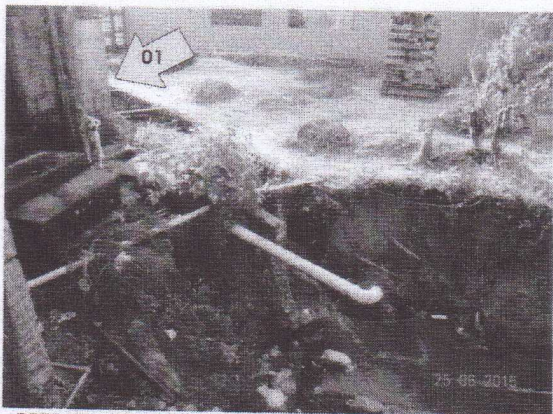
FOTO 03- DETALHE PARA GALERIA DE DRENAGEM ROMPIDA (EFEITOS DA EROSÃO)
