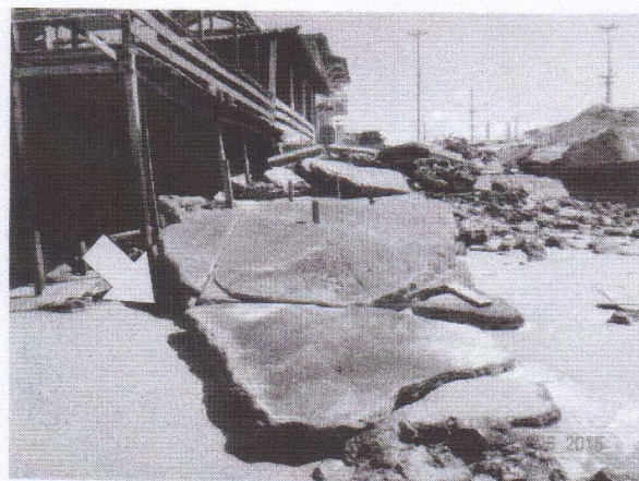
FOTO 28- DETALHE PARA AS RUÍNAS (EFEITOS DA EROSÃO)
