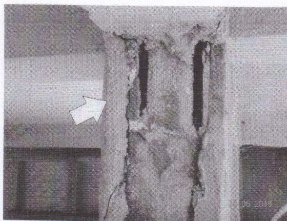
FOTO 14- VISTA GERAL DAS EDIFICAÇÕES DE CONCRETO ARMADO DETALHE PARA OS ELEMENTOS ESTRUTURAIS (PRÉDIO VERDE) ALTO GRAU DE DEGRADAÇÃO DO CONCRETO E DAS ARMADURAS
